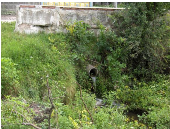
Csatorna kifolyó, a gyár területén kívül
