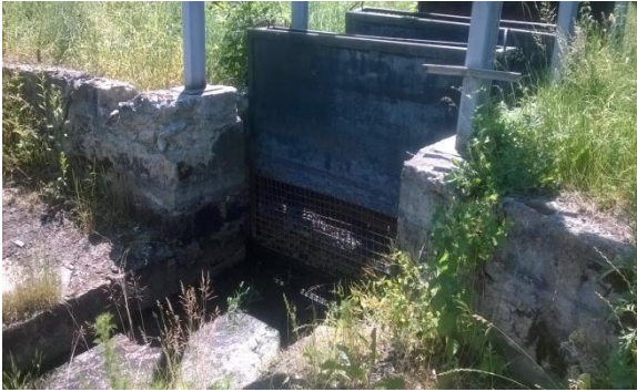
Patakon kialakított víztisztító műtárgy, aktívszenes szűrővel
