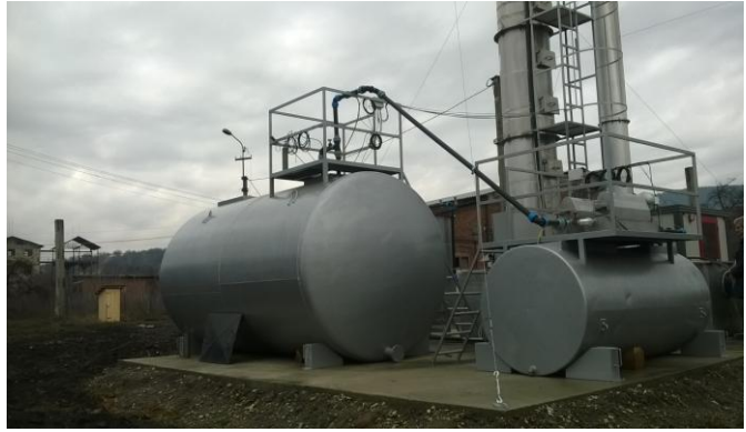
fázissztválasztó tartály, szűrőtartály (vízoldali)
